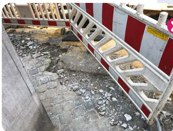
Largeur du libre passage et revêtement inadaptés.
