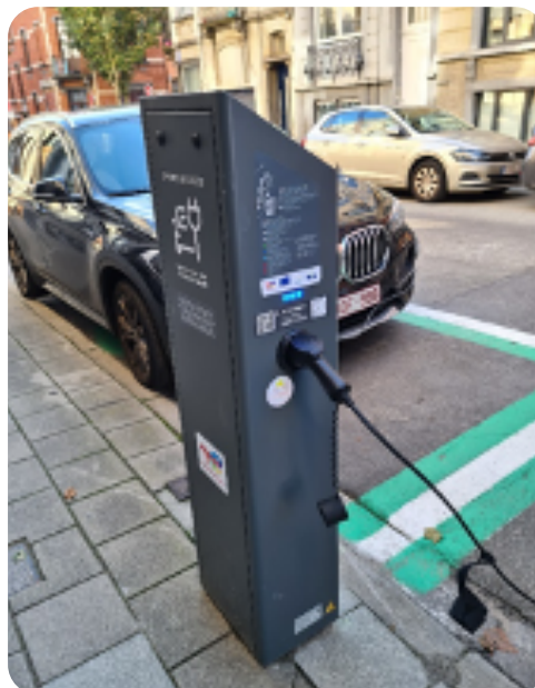
Borne de recharge de véhicule électrique
