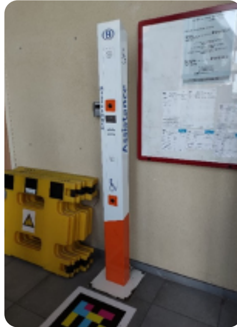
Borne d'assistance PMR en gare
